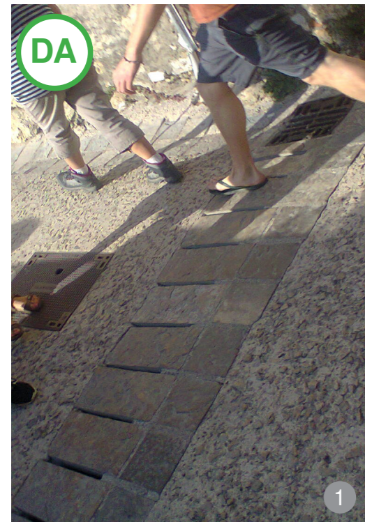
AȘA DA: Rezolvări pentru colectarea apelor pluviale și transversale pe drum duc la o durată mai mare de folosire chiar și a suprafețelor de drenare.
