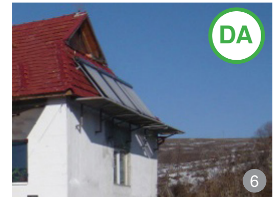
AȘA DA: Panouri solare montate pe „împroșcătorul șurii”. Suprafața panourilor nu va depăși 15% din suprafața totală a acoperișului.
