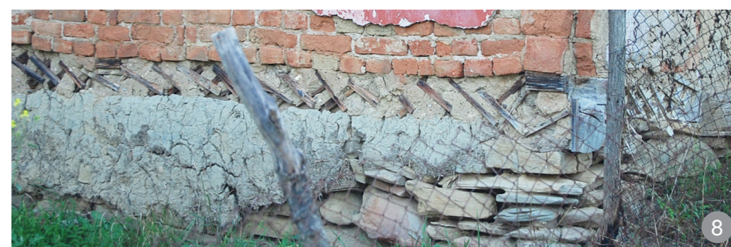
Fundație din lespezi de piatră cu socluri tencuite cu mortare de pământ sub pereți cu structură de lemn umplută cu cărămidă
