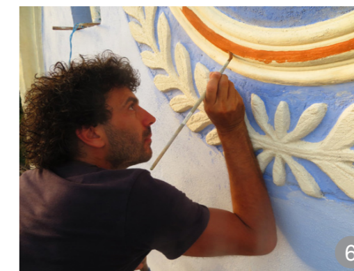
6 Recomandăm folosirea zugrăvelilor naturale pe bază de var și reabilitarea decorațiilor existente.
